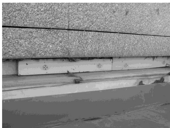
Obr. 4: Vlákenná tepelná izolace posunutá oproti původní poloze, nalevo patrná chybějící tepelná izolace z extrudovaného polystyrenu, která je umístěna pouze v
