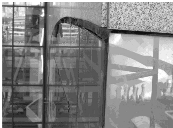
Obr. 10: Degradovaná PU izolace mezi žulovými deskami a dekorativními
