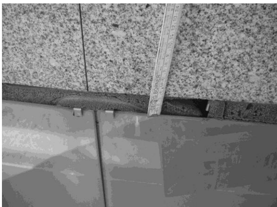
Obr. 9: Degradovaná PU izolace mezi žulovými deskami a dekorativními
