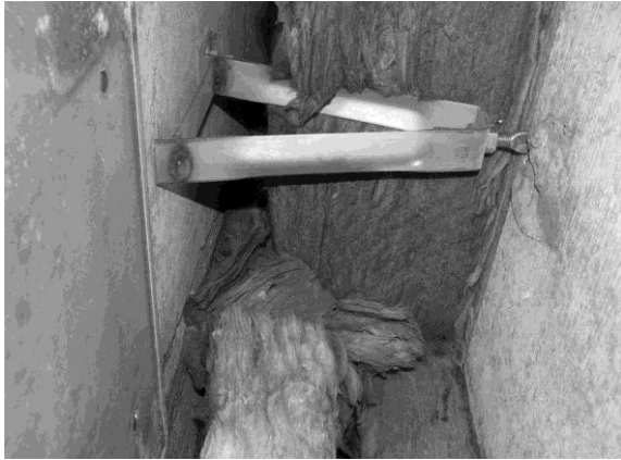
Obr. 5: Tepelná izol. odtržená od nosné stěny
