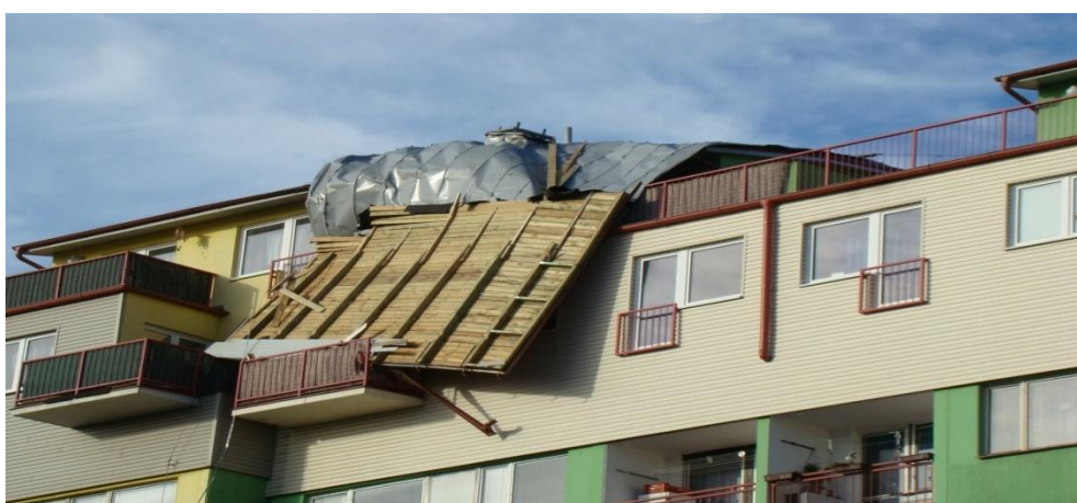
Obr. 2 a 3 : důsledky problematického kotvení po vichřici
