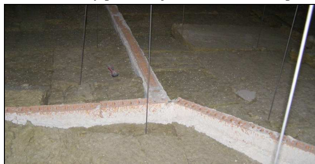
Obr. 4 – Příčky procházející nad úroveň zateplení
