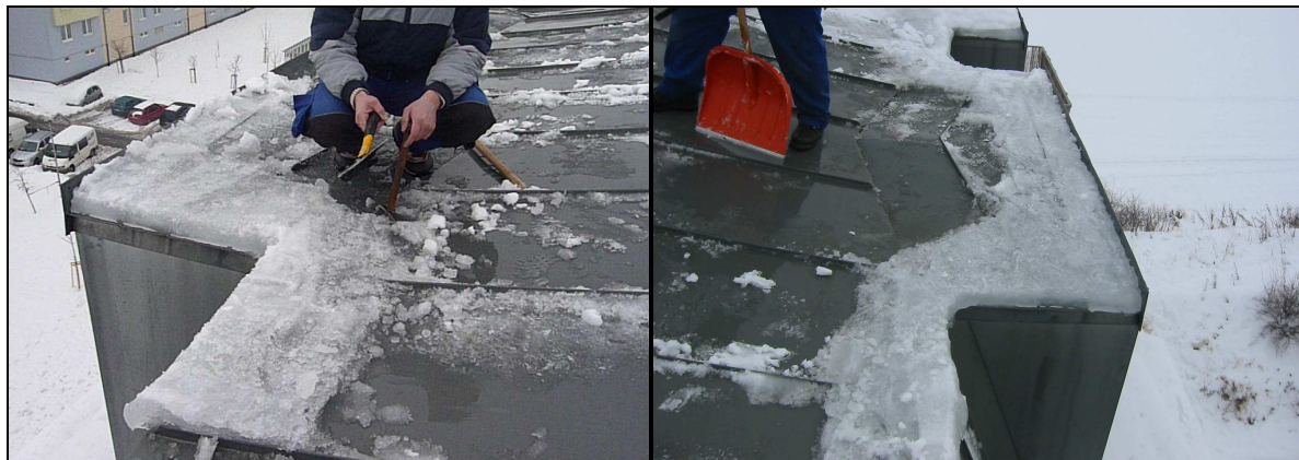
Obr. 1: Ledové valy po obvodě střechy
