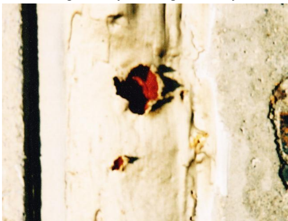
Obr. 3: Popraskaný tmel s povrchovými „krátery“
