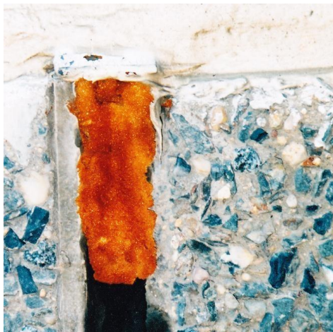
Obr. 8: Obnažená pěnová výplň svislé spáry
