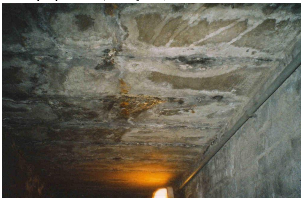
Obr. 4: Výrony trhlinami (cracks ejection)
