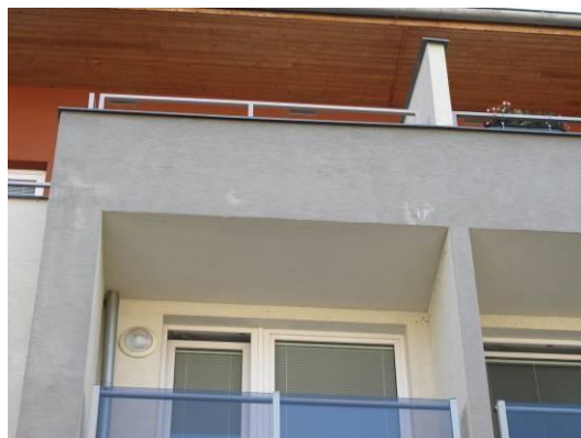
Obr. 2: Stopy po zatékání na fasádě
