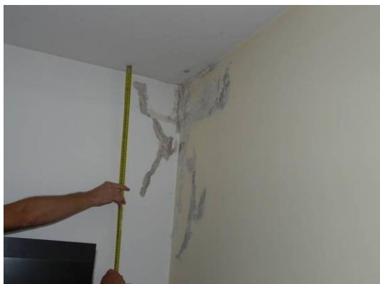
Obr. 3: Stopy po zatékání v interiéru 3NP
