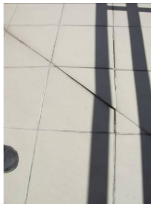
Obr. 4: Poškozená dlažba terasy
