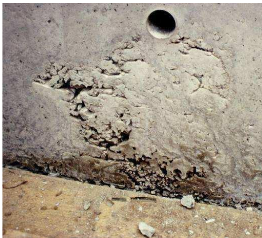
Obr. 2: Nezvibrované místo ve stěně
