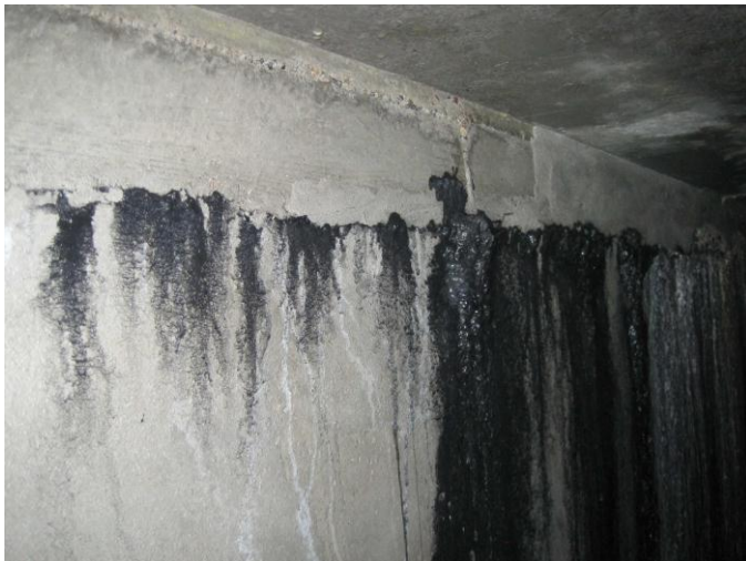
Obr. 4: Vyplavování bentonitového těsnění ze spáry
